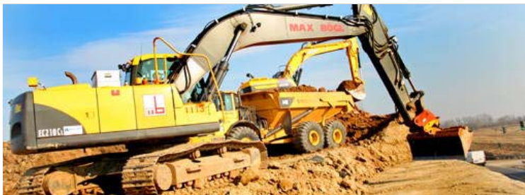
Der Damm wird wieder abgetragen um Fundamente zu setzen. Foto: Jacqueline Schulz
