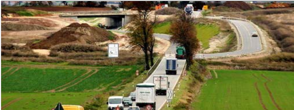
Im Bau: Bei Voigtstedt im Kyffhäuserkreis wird an der A 71 in nördliche Richtung gebaut, das frühere Bergbaugebiet sorgt für Verzögerungen. Foto: Wilhelm Slodczyk
